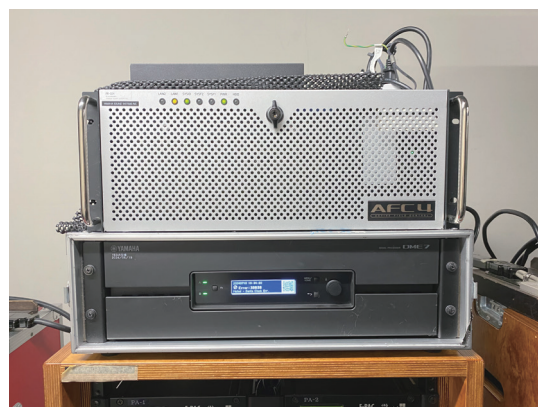
今回大ホールアンプ室に仮設したAFC4とDME7
