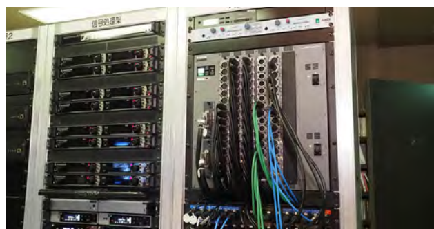
音響調整室 入出力パッチ架内の入出力ボックス
