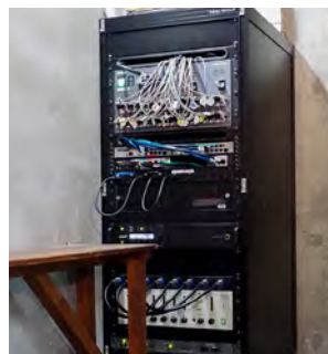
下手AD/DAラック
