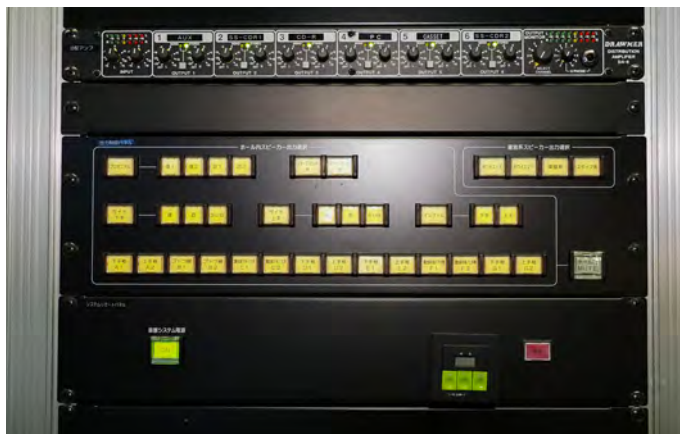
出力制御パネル、システムリモートパネル
