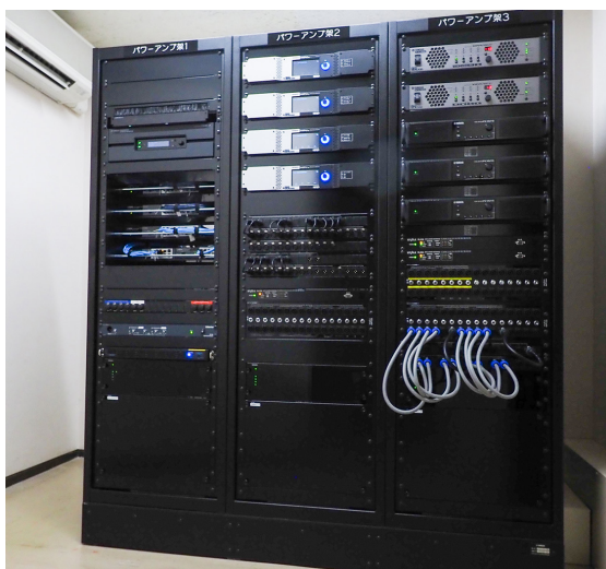
アンプ室 パワーアンプ架
