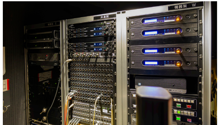
音響調整室 共通架、機器架
