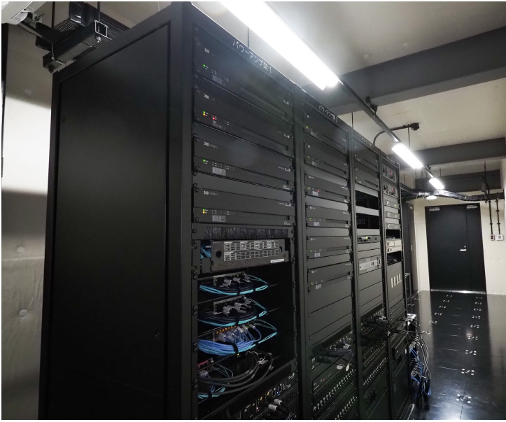
アンプ室 パワーアンプ架
