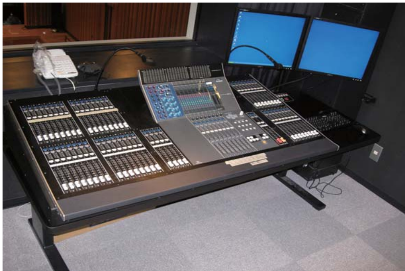
音響調整室内
