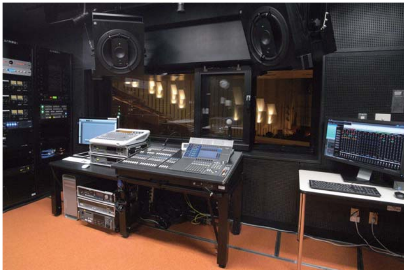
音響調整室内
