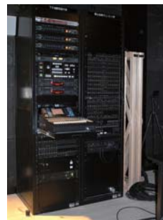
左：下手袖簡易操作盤
