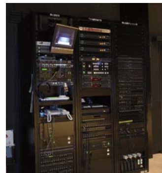
左：舞台連絡架 中：下手袖簡易操作架 右：舞台袖集中コンセント架
