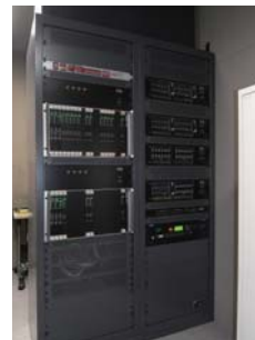
調整卓信号制御部
