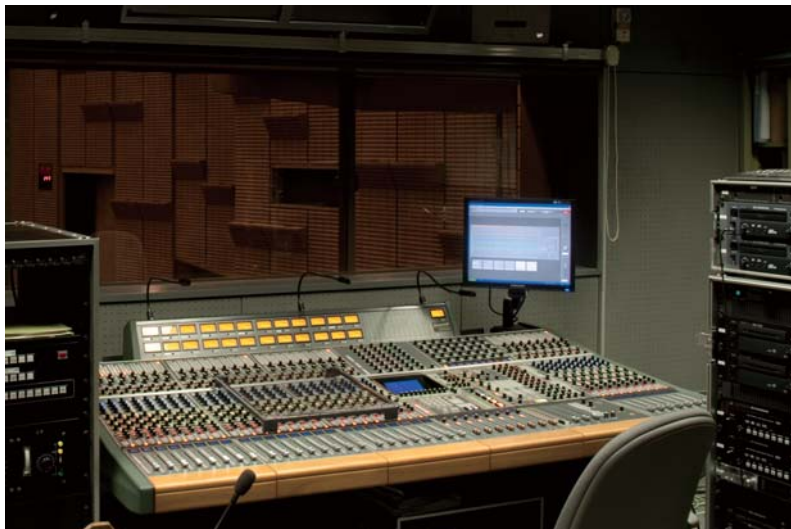
音響調整室内
