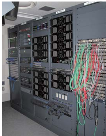
左から 信号処理架-1,2 電力増幅器架-1,2 入力パッチ架
