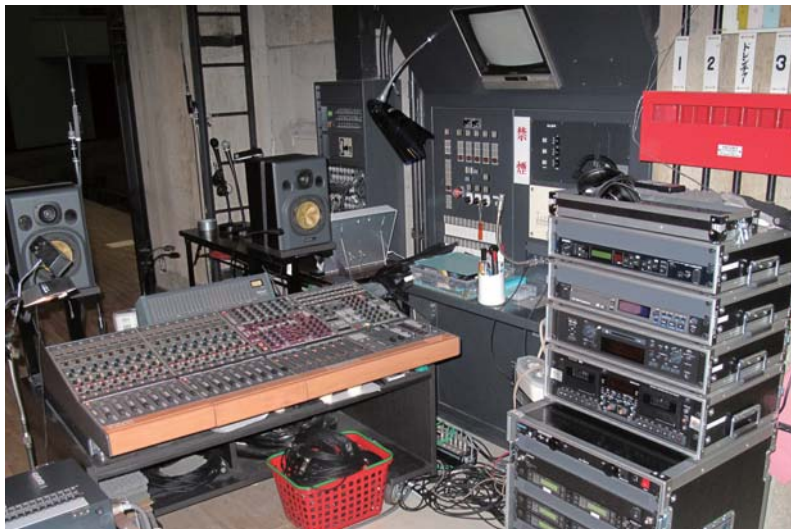
舞台下手袖音響調整卓スペース
